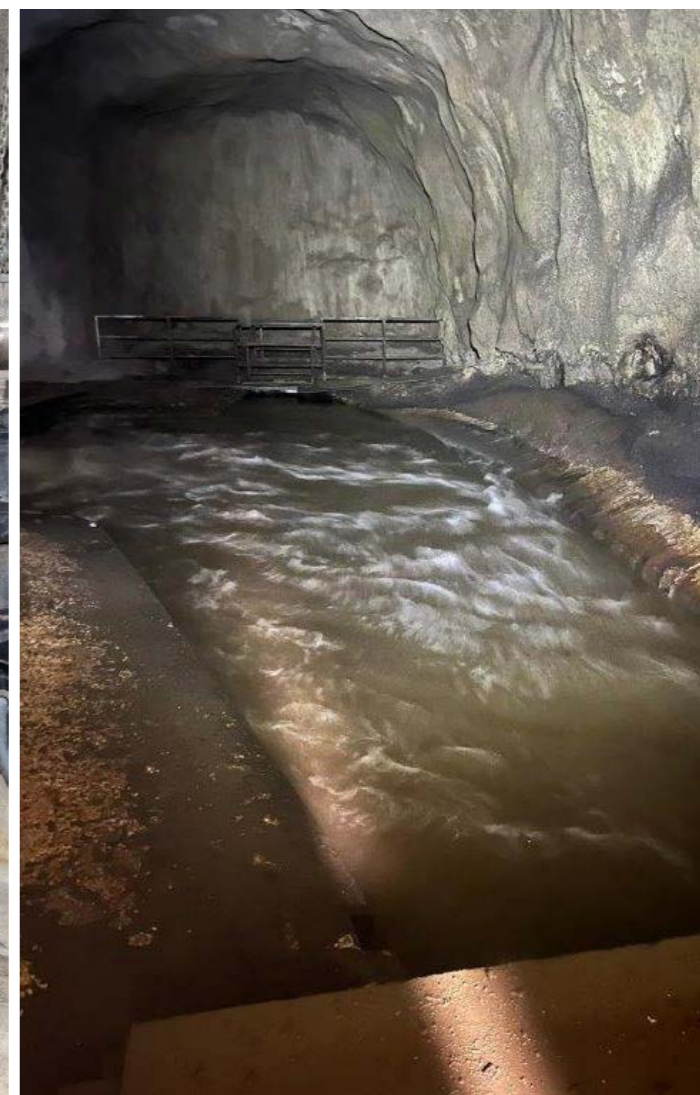
Pihlajamäki jätevesien pumppaus
